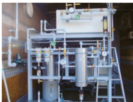
バイオガス精製装置
