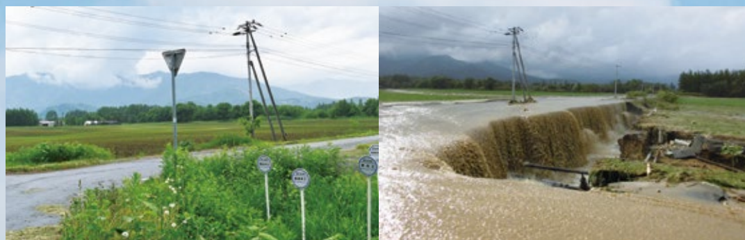
2016年の水害時、畑がえぐられ道路から滝のように濁流が落ちている様子（写真右）。災害復旧工事を経て元通りになり、今は麦畑やデントコーン畑になっています（左）。
