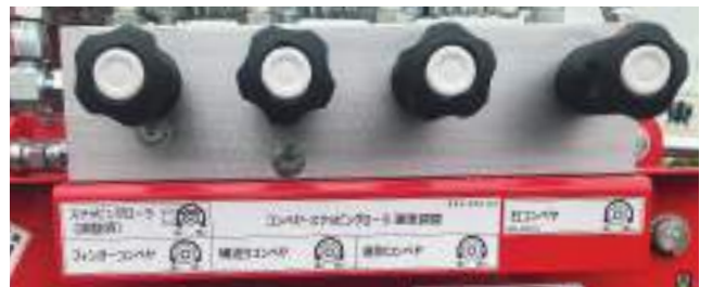
コンベヤの回転速度調整バルブ
