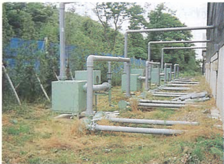
エアレーション施設
