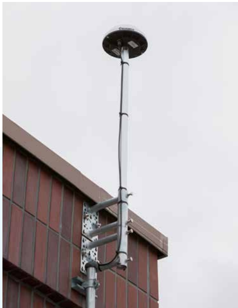
JA ようていが倶知安支所の屋上に設置したRTK 基地局。基地局からの信号を受信可能な周辺のJA から共同利用の依頼があるとのこと。
