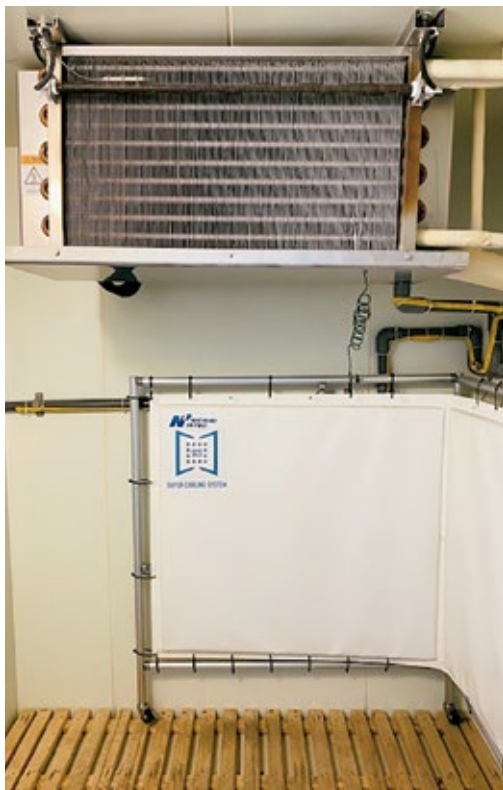
写真 2. プレハブ低温貯蔵庫内に設置したSCSのパネル（写真下）
