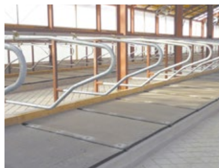
写真 2. ボビレックスが設置された牛舎
