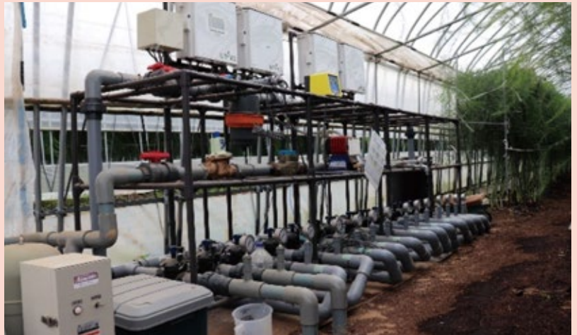
写真1.灌水の自動化事例(檜山農業改良普及センター)
