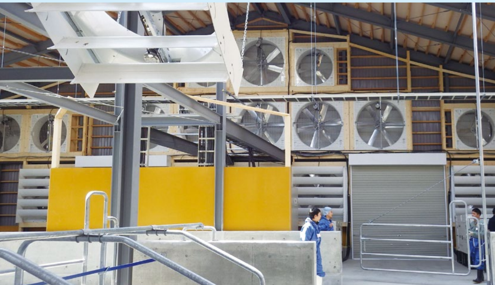
写真2.大型牛舎の機械換気システム（酪農試験場資料より抜粋）
