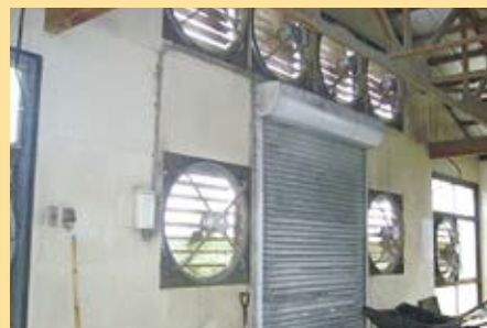
写真2. トンネル換気。
