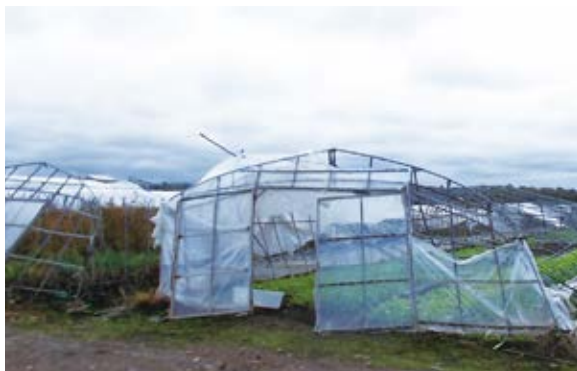
写真 1. 風害を受けたハウス。
